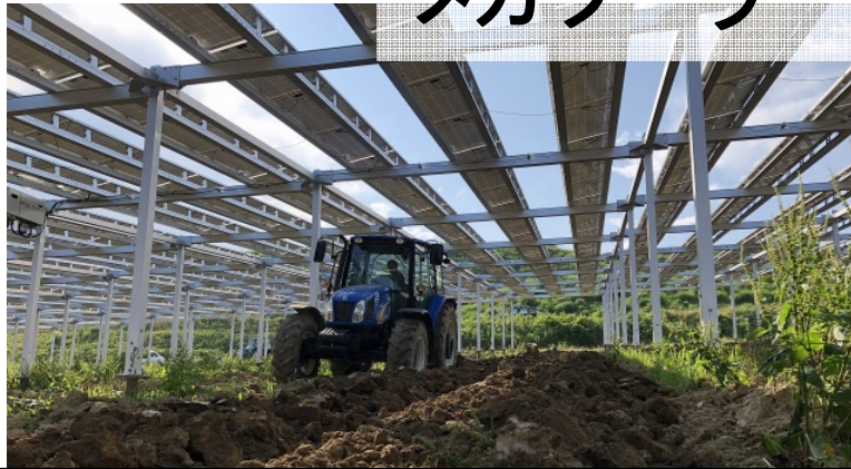
一関市吉高太陽光発電所
