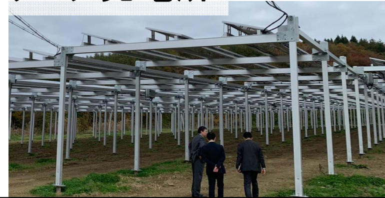
一関市鈴ヶ沢太陽光発電所
