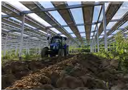
一関市吉高太陽光発電所の様子
