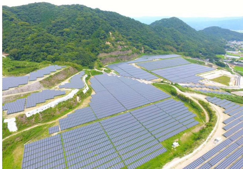
発電所の様子
